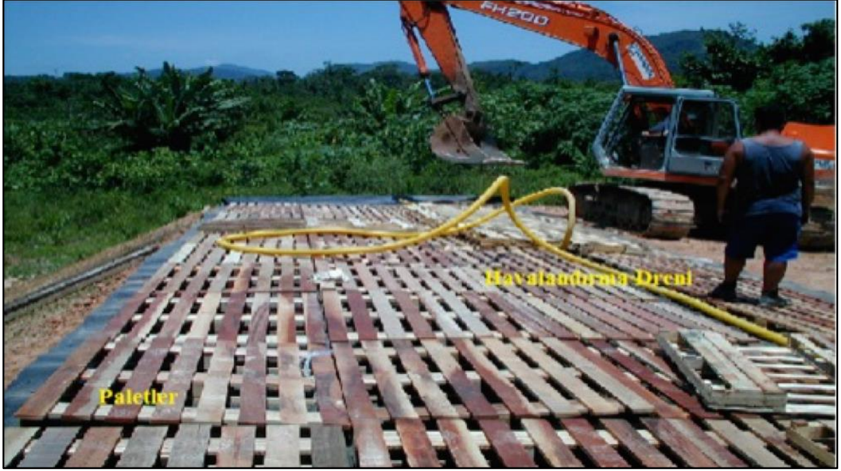
Şekil 3.4. MBA Tesisinde Kullanılan Paletler ve Havalandırma Dreni
