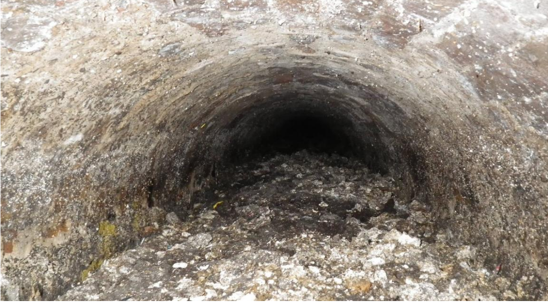
Şekil 2. Kanalizasyon Sistemini Tıkayan Kızartma Yağları ve Islak Mendiller.
