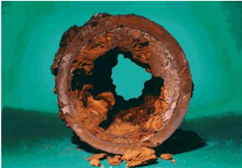
Şekil 3. Kızartma Yağları İle Bloke Olan Kanalizasyon Borusu
