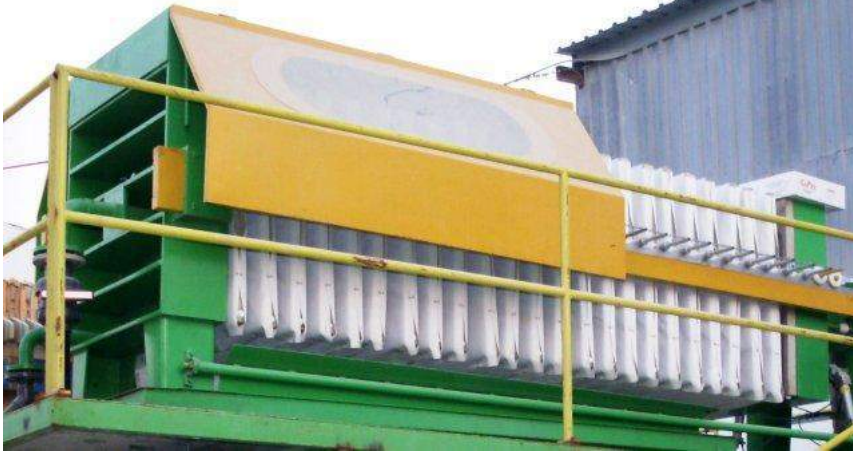
Şekil 3. Mermer Atıksuyu Arıtma, Çöktürme Tankı ve Filtre Pres Üniteleri
